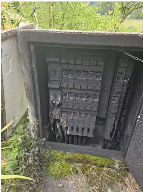
Kurzschluss an der Einspeisesicherungsleiste mit starker Rauch- bzw. Russentwicklung
