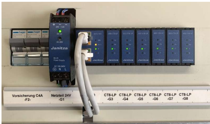
Messgeräte mit Anbindung an das Leitsystem
